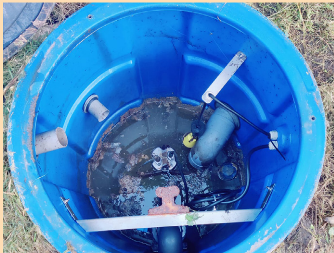
Pompe de relevage
