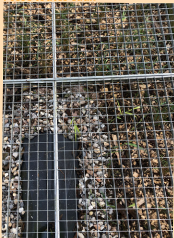
Fosse toutes eaux
